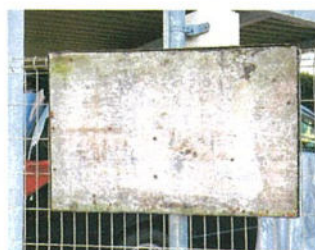
掲示板修繕前
